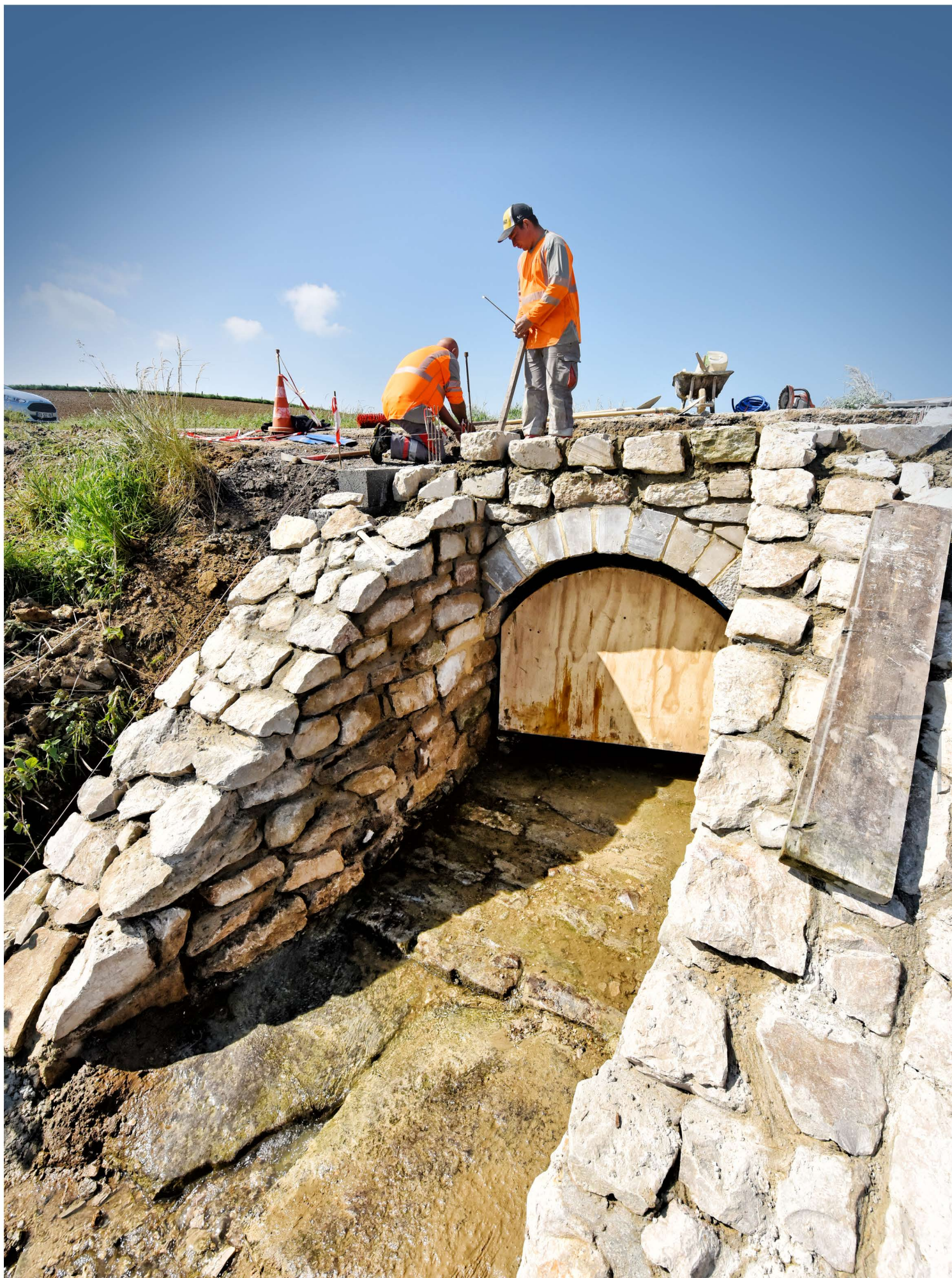
Préserver et restaurer le patrimoine avec le souci du détail, une priorité du Grand Site ! Travaux sur la rue du Panché à Audinghen.
